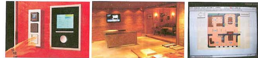
Der Hanneshof setzt auf den Gira HomeServer als Zentralstelle im Haus (Bild links), Auch in der „Kellerstube“ kommt man aus dem Staunen nicht mehr heraus (Mitte), Eine Visualisierung ist bei solchen Anlagen schon eine Selbstverständlichkeit (rechts)
